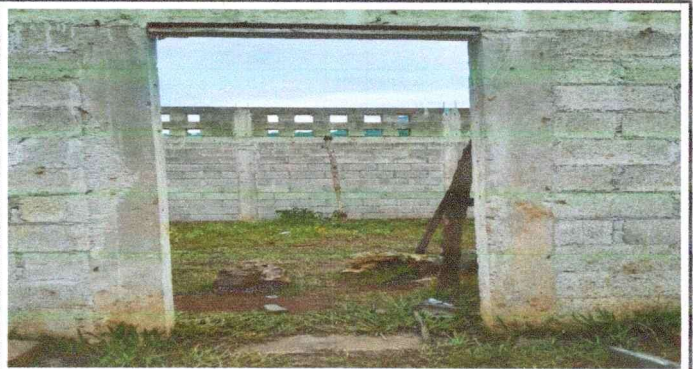
Foto 4: Rehabilitación de puertas a metal y cernido de paredes interior y exterior.
