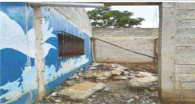
Foto 5: Rehabilitación de puertas, cernido de paredes y torta de concreto de cemento.
